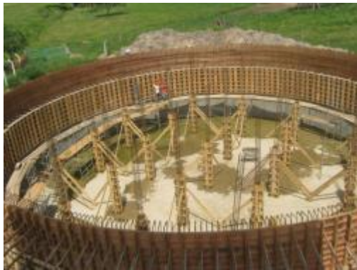
Reservatório Enterrado de 2.000 m 2
