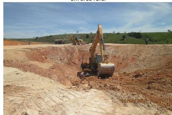
TC/PAC 0174/2012 - Mucurici - Terraplanagem para formação das paredes da lagoa Anaeróbia da ETE
