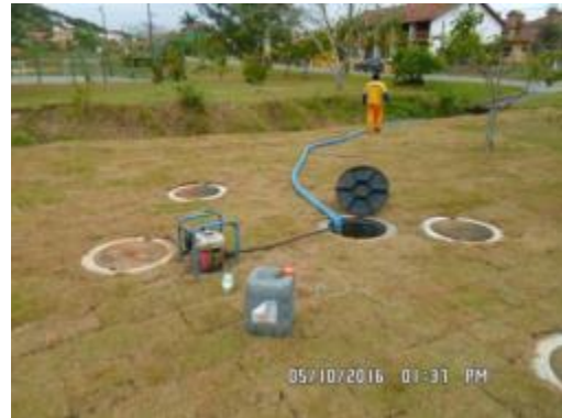
Estação Elevatória 02 - Garopaba
