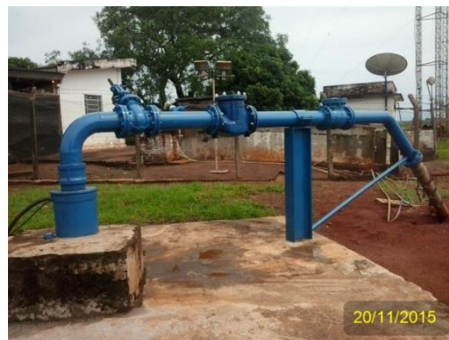
TC/PAC 793/2009 - Nova Europa - Barrilete de saída do poço 13 de Maio
