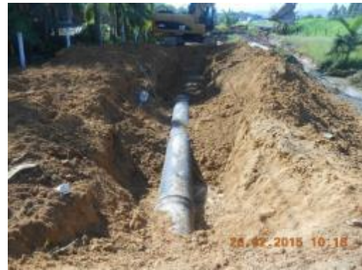
Adutora de Água Tratada do S.A.A
