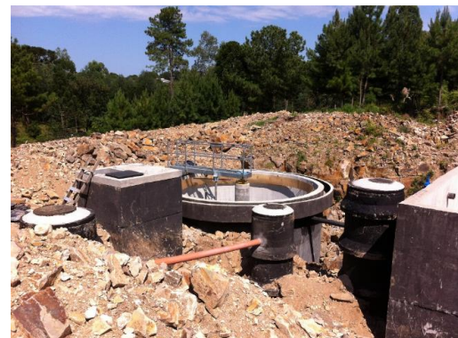
TC/PAC-0570/07 – Fontoura Xavier – Tanque de Tratamento secundário
