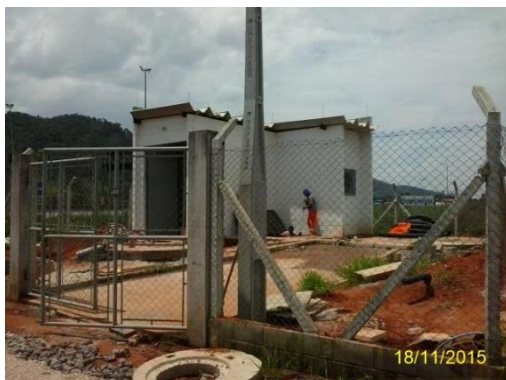
TC/PAC 987/2009 - Guararema - Vista da EEE2
