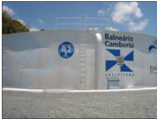
Reservatório Metálico de água Tratada
