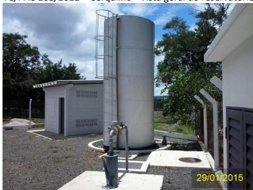
TC/PAC 282/2012 – Alambari - Vista do SAA-Ribeirãozinho
