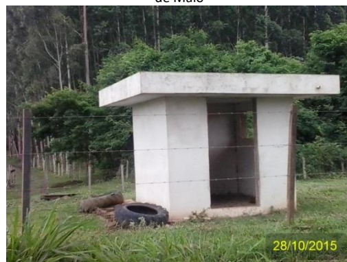
TC/PAC 155/2012 – Vargem Grande do Sul - Poço de sucção e Casa de bombas da EEE Perobeiras
