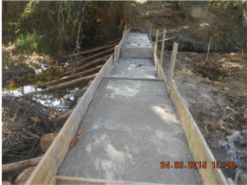
TC/PAC-0058/07 – Brejetuba - Barragem de Elevação
