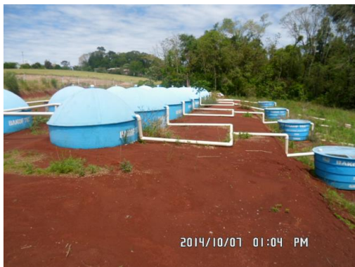
TC/PAC-0567/2007 – Almirante Tamandaré do Sul - Estação de tratamento
